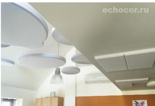
Панели ЭхоКор под потолком офиса
